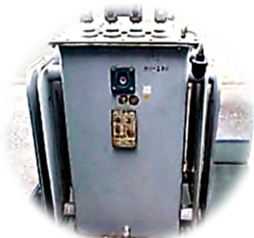
変圧器(トランス)
