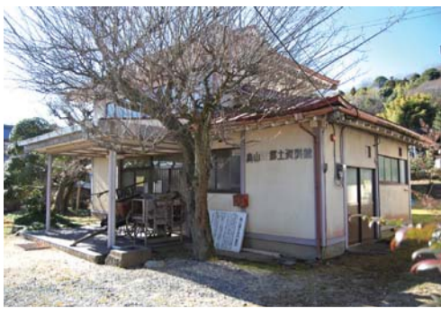
老朽化等が懸念される資料館
