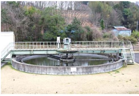
烏山水処理センター内の施設の1つ沈殿池
