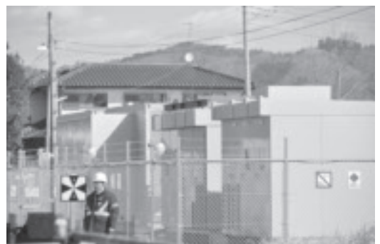
試験走行時に公開された充電設備の一部。
