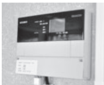
烏山庁舎の節電監視装置。
