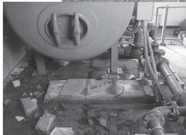
西野配水場では圧力タンクが台座から1mほど動いたため地域への給水がストップ(写真下)。
