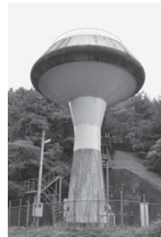
境東簡易水道配水池
