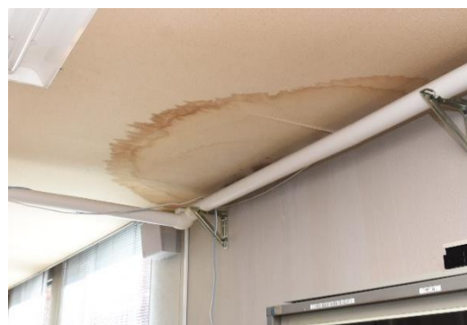
3階天井の雨漏り痕跡
