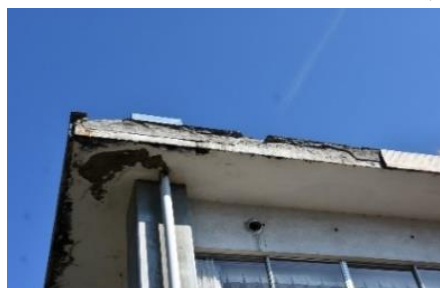
崩落した側面タイル
