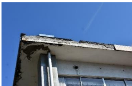
崩落した側面タイル
