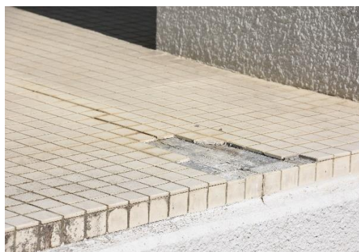
タイルの剥離
