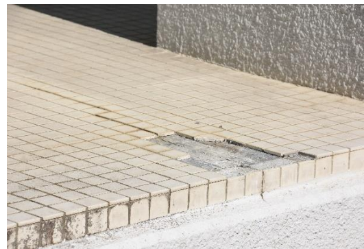
タイルの剥離
