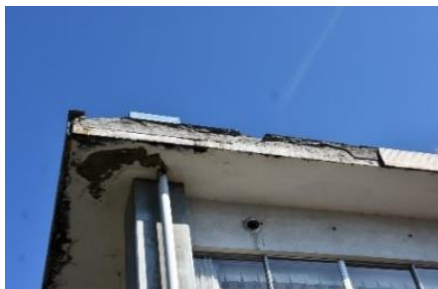
崩落した側面タイル
