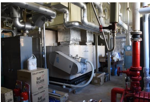
老朽したボイラー室
