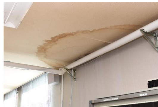
3階天井の雨漏り痕跡
