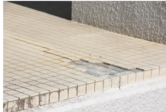
タイルの剥離
