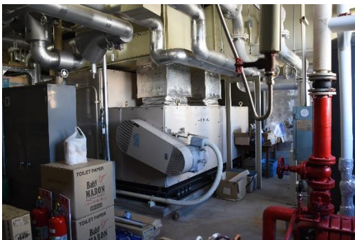
老朽したボイラー室
