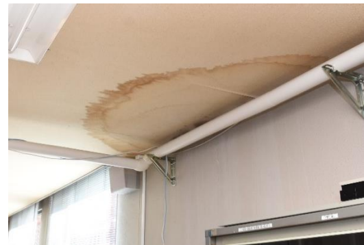
3階天井の雨漏り痕跡
