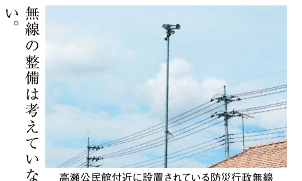
高瀬公民館付近に設置されている防災行政無線
