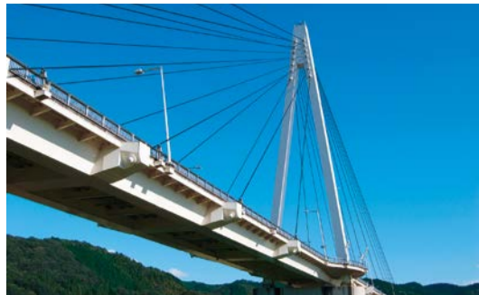
水道管が添架されている烏山大橋
