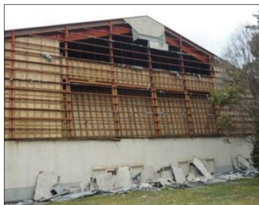
外装材の脱落
