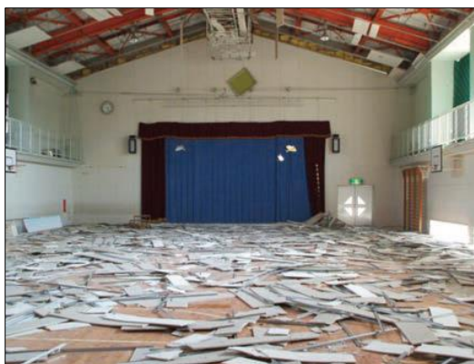
屋内運動場の天井材の脱落
