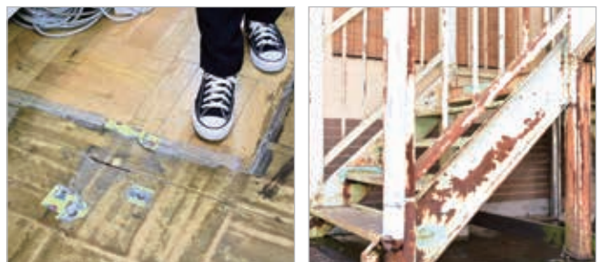
老朽化が進む市庁舎
