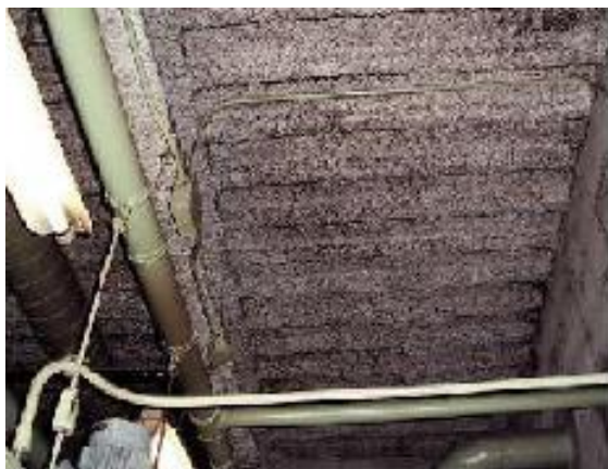
石綿含有吹付けロックウール
