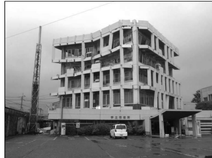
被災した宇土市役所本庁舎（平成28年5月9日撮影）
