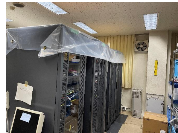
大雨時はサーバラックにビニールカバーをかけ雨漏り対策
