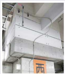
建物を支える免震装置
