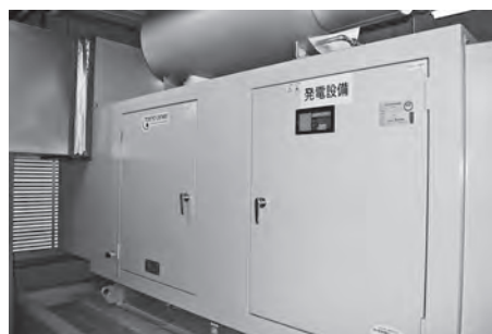
那珂川町役場の非常用発電設備
