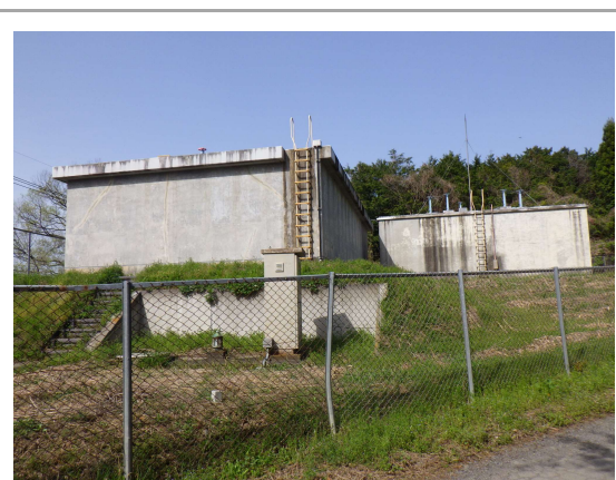
写一2.6 志島配水場
