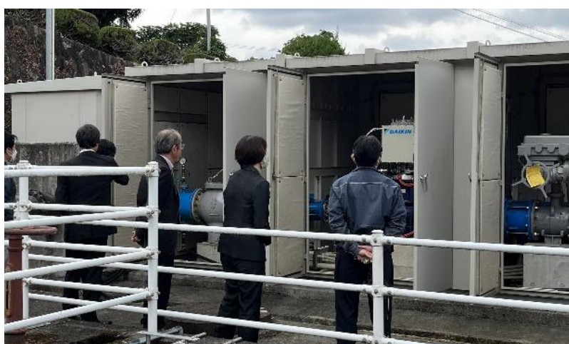
浄水場内に設置された発電設備を見学する委員
