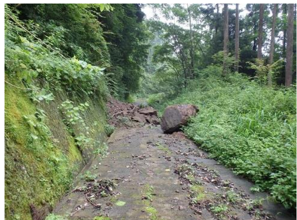
林道の損傷箇所 ▶
